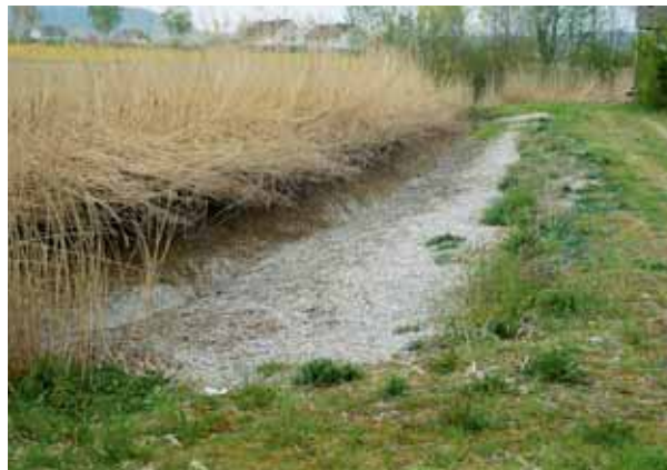
SABA Chrebsbachknie: Kiesfilter im Ufer des Sedimentationsteiches, nach zehn Betriebsjahren und zweimaligem Ersatz der obersten zwanzig Zentimeter, August 2006.
